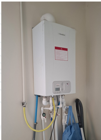
Sistem de încălzire și asigurare a apei calde menajere alimentată cu gaz.
