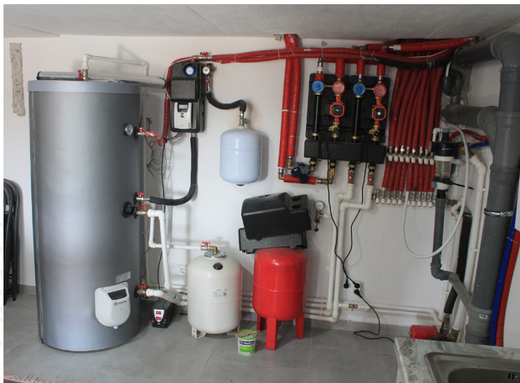
Sistem de încălzire bazat pe colectoare solare.
