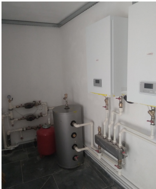
Sistem de încălzire cu cazan electric alimentat de panouri fotovoltaice.
